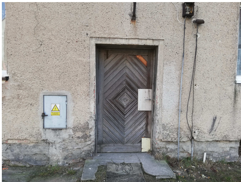
Zdj. nr 5 Drzwi do wymiany – elewacja północna
