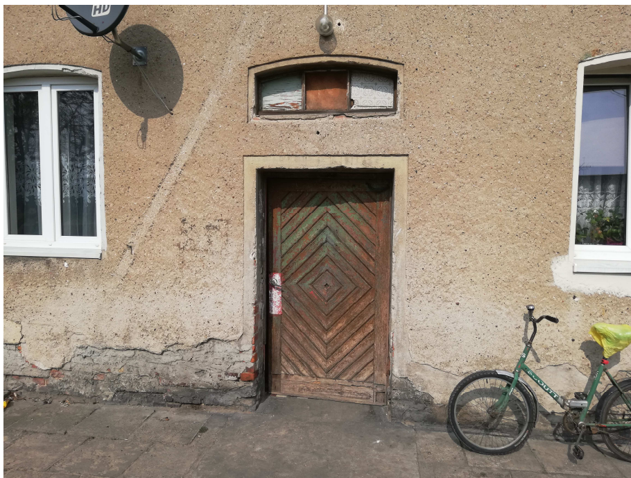
Zdj. nr 4 Drzwi i okno do wymiany wg wyglądu historycznego
