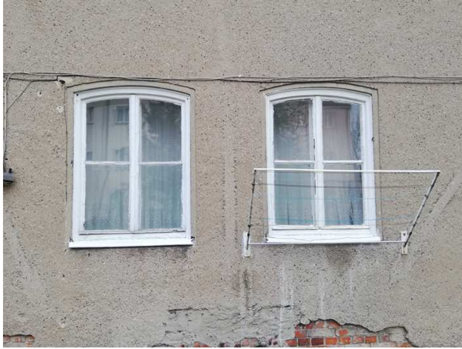
Zdj. nr 5 Elewacja zachodnia. Widok historycznych okien do wymiany.
