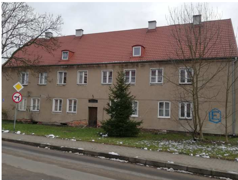
Zdj. nr 2 Widok elewacji zachodniej. Okna drewniane oraz drzwi i naświetle do wymiany.
