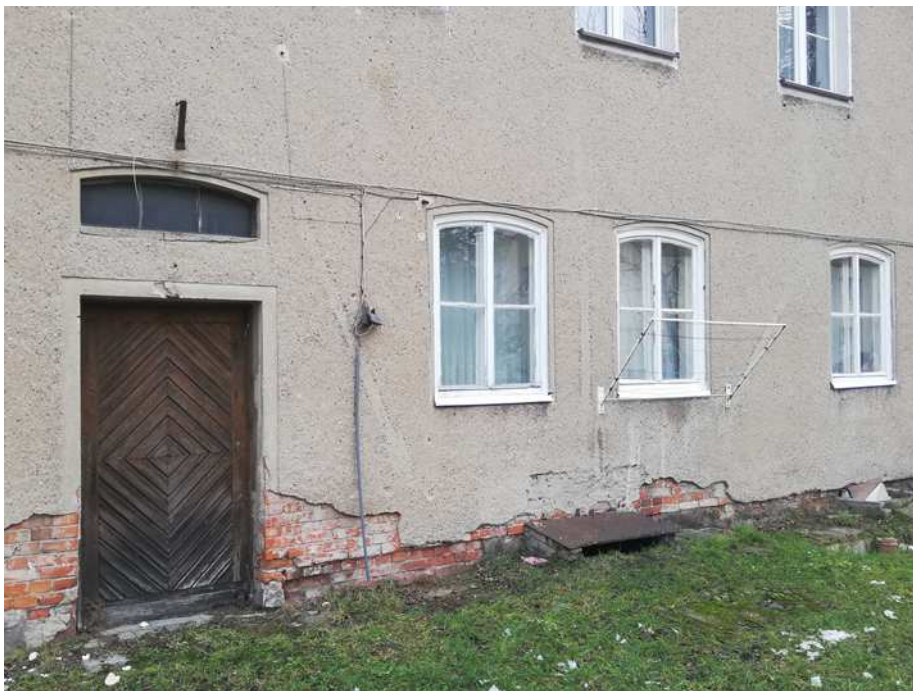
Zdj. nr 4 Elewacja zachodnia, drzwi i okna przewidziane do wymiany. Należy zachować historyczny wygląd stolarki.
