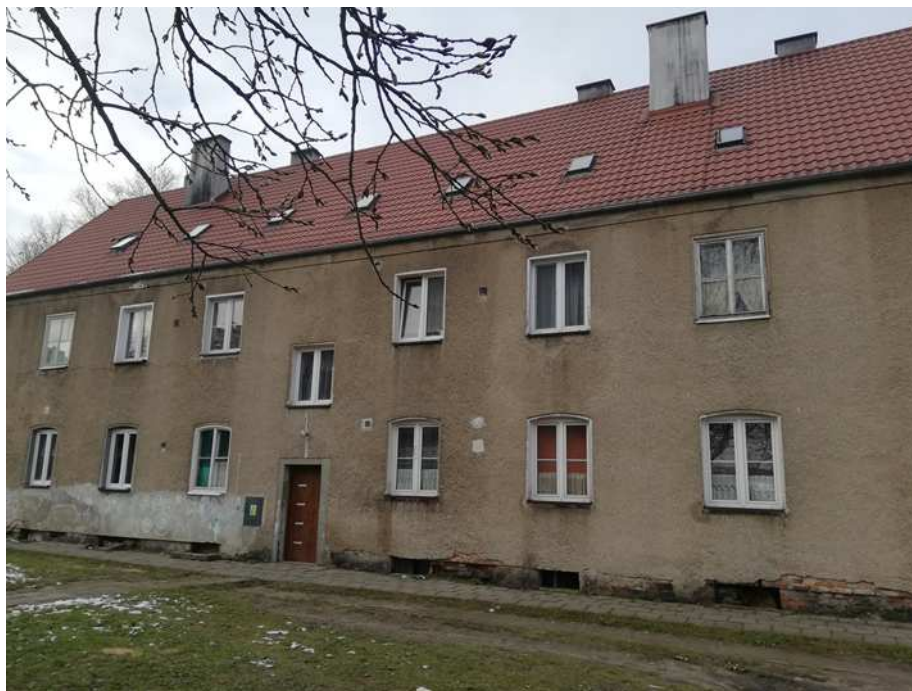
Zdj. nr 1 Widok elewacji wschodniej. Okna drewniane do wymiany.
